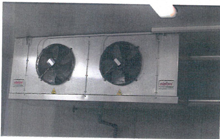
Particolare impianto frigorifero
